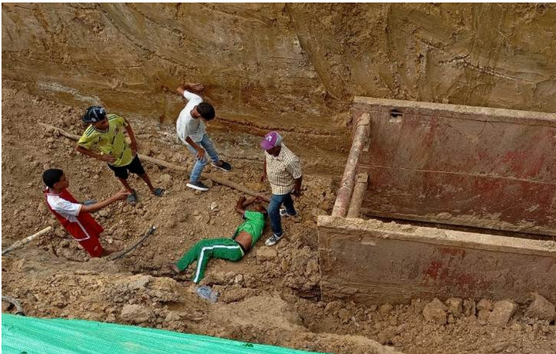
Instante cuando ciudadano que cayó a la zanja, recibía primeros auxilios.
